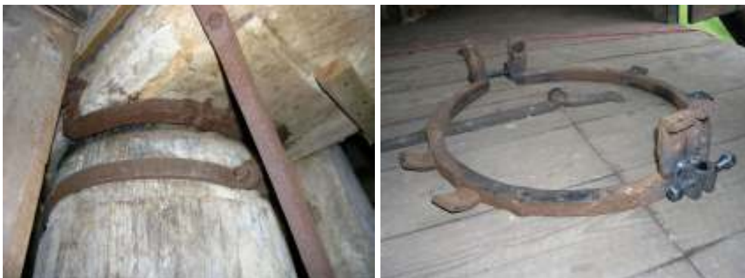
Stubbe med nedslitna ytor och skadad stenkalksring t v och stenkalksring efter restaurering t h.
