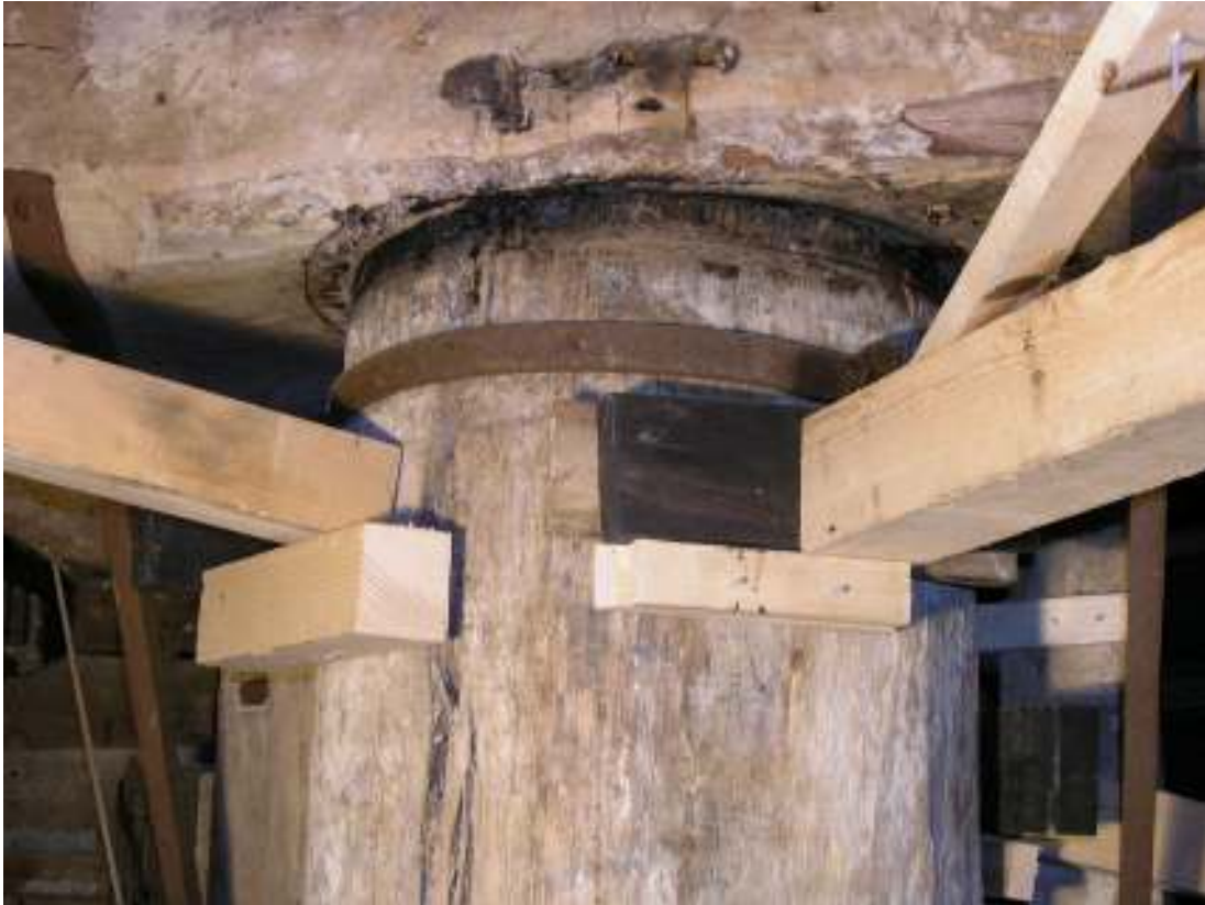
Stubben har stagats upp för att underlätta justering av stenbjälke och restaurering av stenkalksring.
