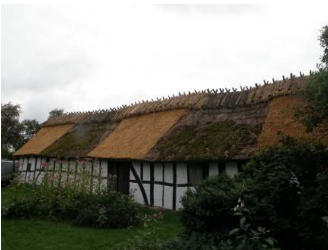
Västra längan efter omtäckning. Norra stiet längst till vänster, södra stiet längst till höger.
