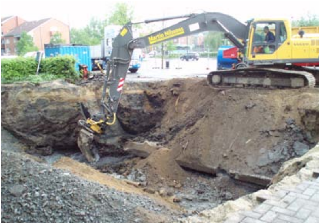
Fig 4. Schaktning. Strax under mitten av bilden syns det betonggolvet som låg i bensinmackens källare.
