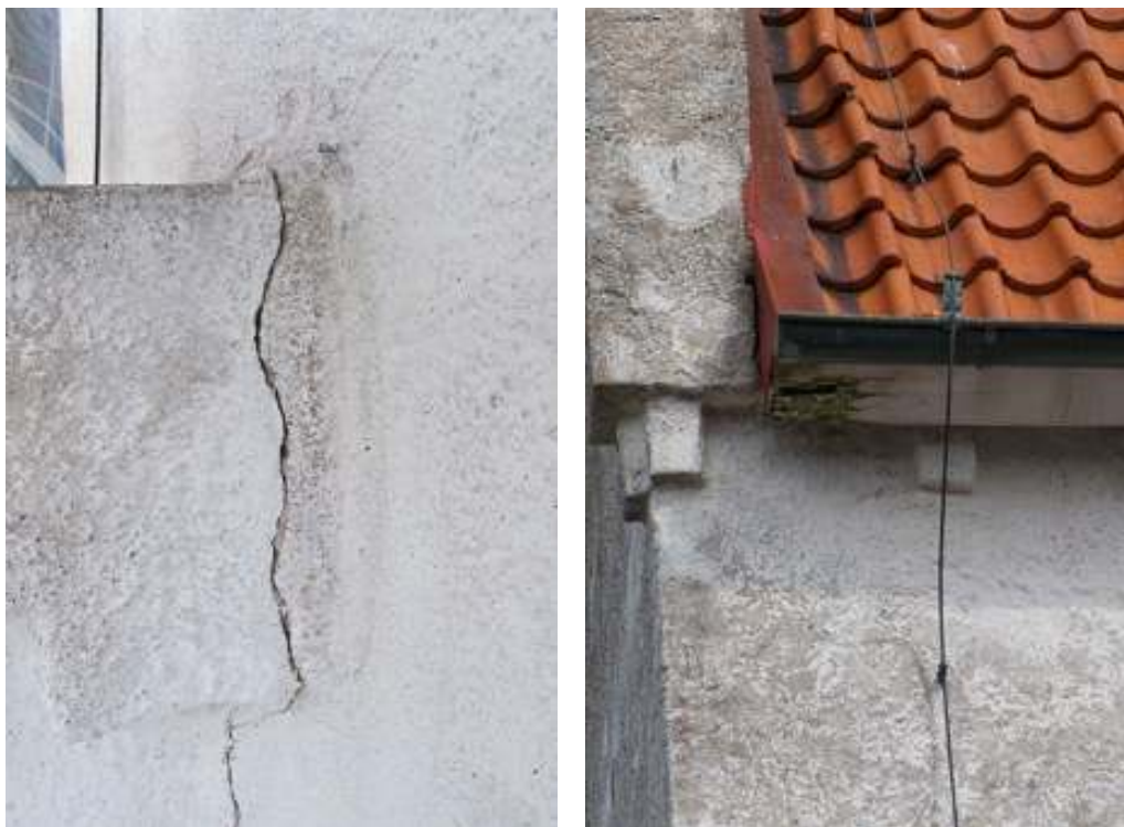
T.v.: Spricka vid strävpelare innan renovering.
